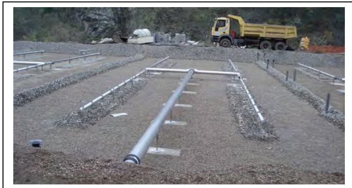
La nouvelle station, Bientôt les roseaux couvriront les 12 systèmes d'épandages, ( 6+6), 1 sur la photo.
