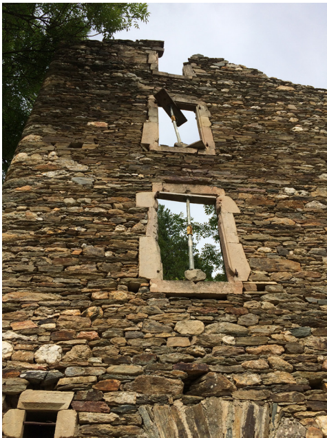
Bâti ruiné à réhabiliter
